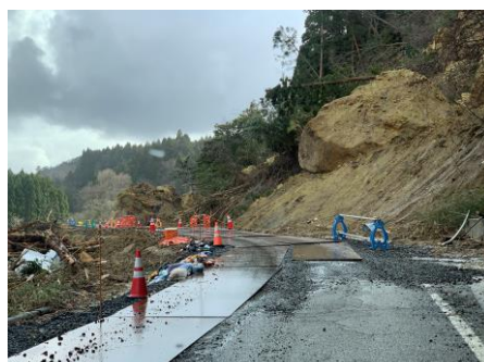
がけ崩れ脇を通り現場へ通う
