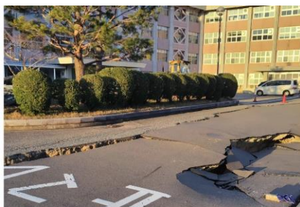
テニスコート 正面敷地内通路の崩落状況
