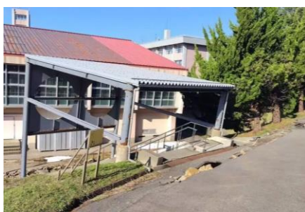
屋外階段の滑動
