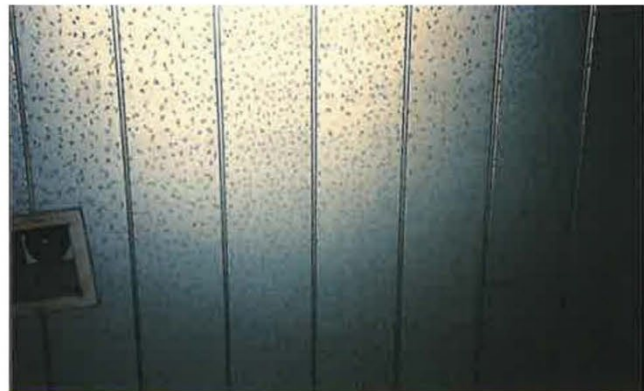
■共用廊下天井の著しい剥がれ
