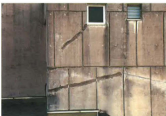
■外壁の「著しいひび割れ」
