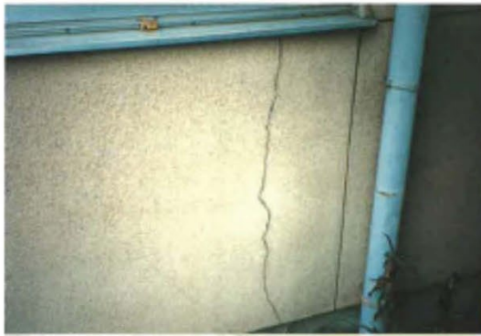
■モルタルの「著しいひび割れ」
