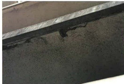
■ バルコニー天井の「著しい欠損」
