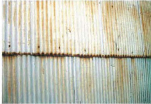
■ 金属板の「著しい腐食」
