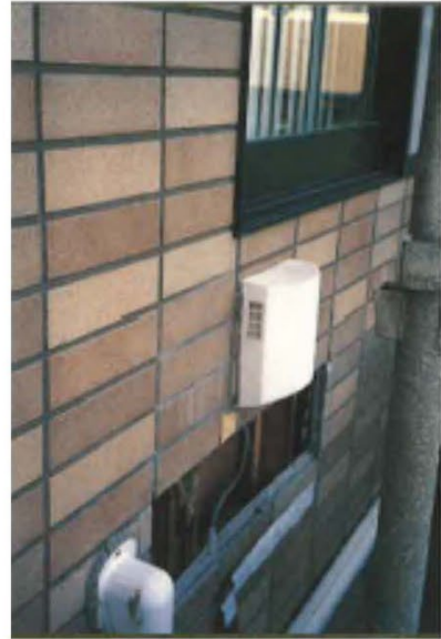
■タイルの「著しい欠損」
