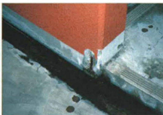
■外壁の「著しい欠損」
