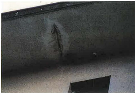
■ 軒天の「著しいひび割れ」
