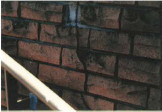
■タイルの「著しいひび割れ」
