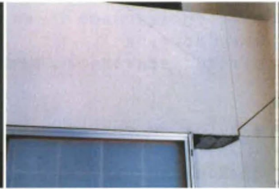
■モルタルの「著しいひび割れ・欠損」
