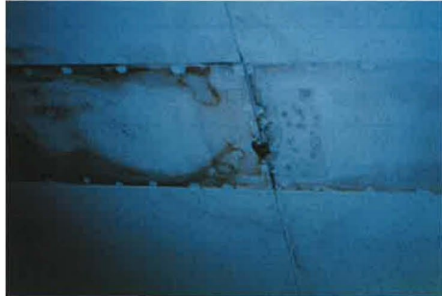
■共用廊下天井の著しい剥がれ
