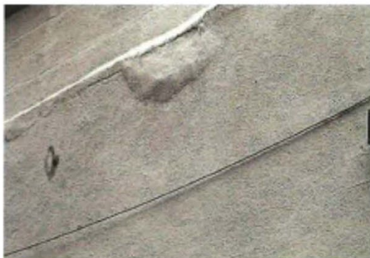
■モルタルの「著しい浮き」
