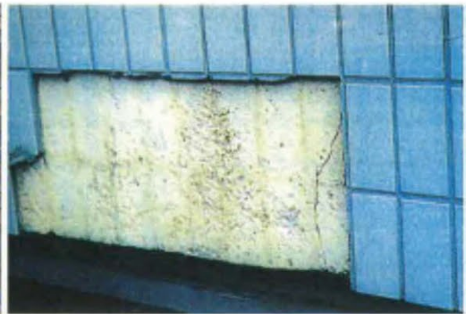
■タイルの「著しい剥がれ」
