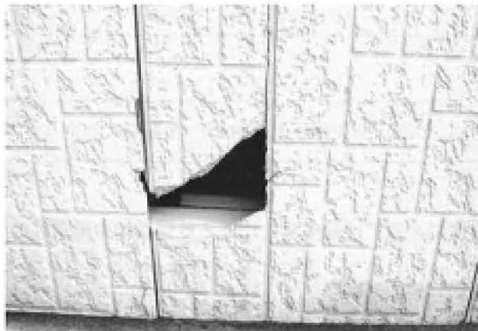
■「仕上げ材の著しい欠損」(窯業系サイディング)
