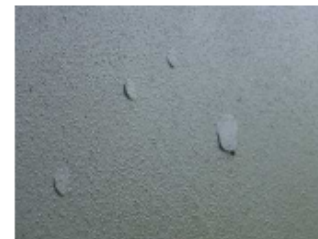
●ポップアウトして仕上材を押し出している例
