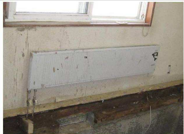
写真8: 壁に設置されたパネルラジエーターの温水配管に浸水の形跡がある。
