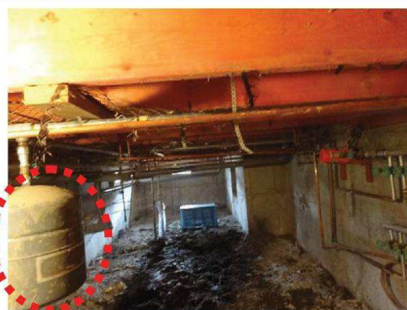
写真4：床下の設備機器に浸水した形跡がある。
