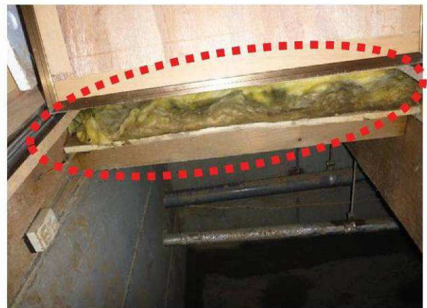
写真6: 床上への浸水により、床の断熱材が水と汚泥により汚損している。
