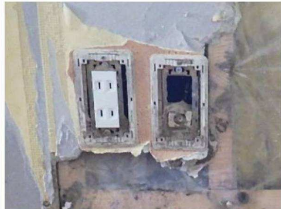
写真12：壁に設置されたコンセントボックス内に汚泥が残っている。
