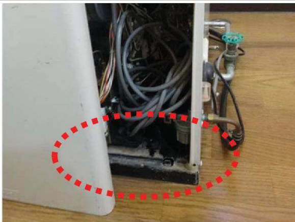
写真7: 床に設置した設備が浸水し、内部に汚泥が侵入した形跡がみられる。
