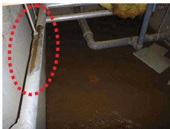
写真3：床下への浸水により、設備配管の保温筒が水分を含んでいる。
