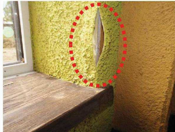
写真10：内装仕上げ及び下地材が水分を含み、膨張・剥離している。
