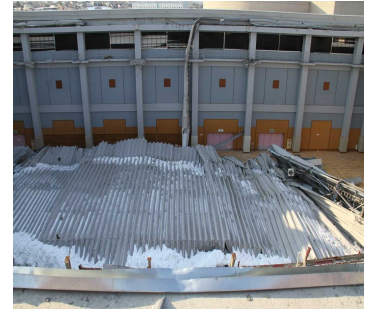
体育館の屋根崩落被害(埼玉県)
