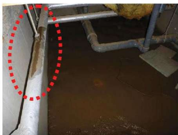
写真3：床下への浸水により、設備配管の保温筒が水分を含んでいる。
