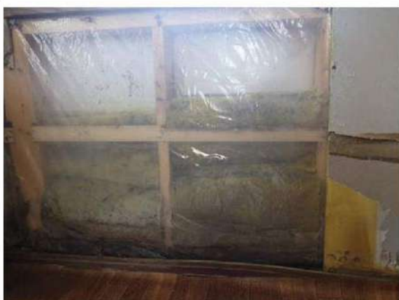
写真11：壁内部の断熱材が吸水し、脱落している。
