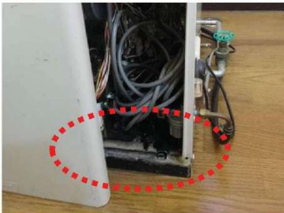
写真7: 床に設置した設備が浸水し、内部に汚泥が侵入した形跡がみられる。
