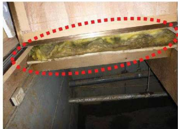
写真6: 床上への浸水により、床の断熱材が水と汚泥により汚損している。
