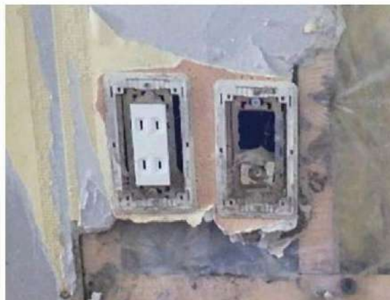
写真12：壁に設置されたコンセントボックス内に汚泥が残っている。
