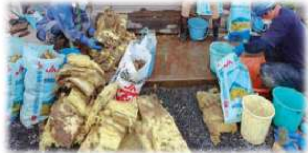
浸水したグラスウール
