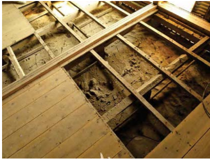
（被害状況の例）
