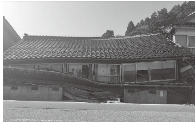
能登半島地震による被害を受けた民家
